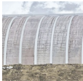
Die Lärmschutzwand bei Hüfingen hat Risse. Foto: NQ-Archiv
